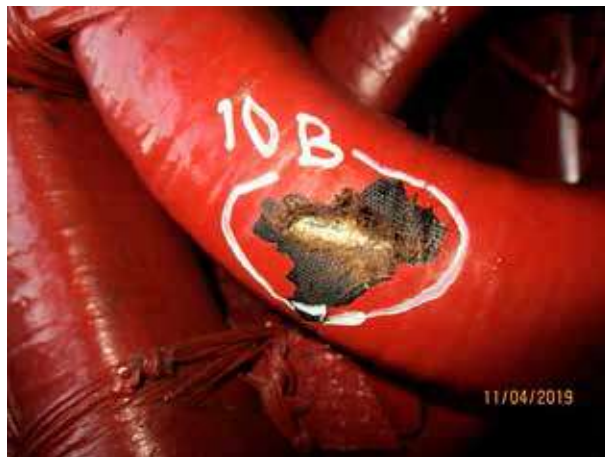
Рис. 4. Повреждение изоляции нижнего стержня фазы В межслоевыми колодками
