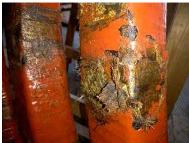
Рис. 6. Повреждение изоляции стержня посторонним предметом
