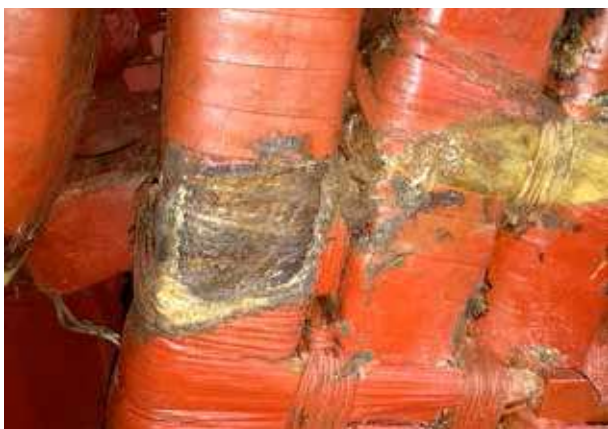
Рис. 5. Повреждение покровной ленты и начало истирания изоляции верхних стержней, вынутых из паза при обследовании поврежденного стержня
